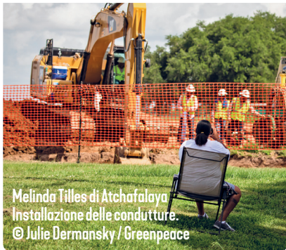
31 marzo 2018. Acadia Parish, Louisiana. Costruzione dell'oleodotto sul ponte Bayou. © Julie Dermansky / Greenpeace
