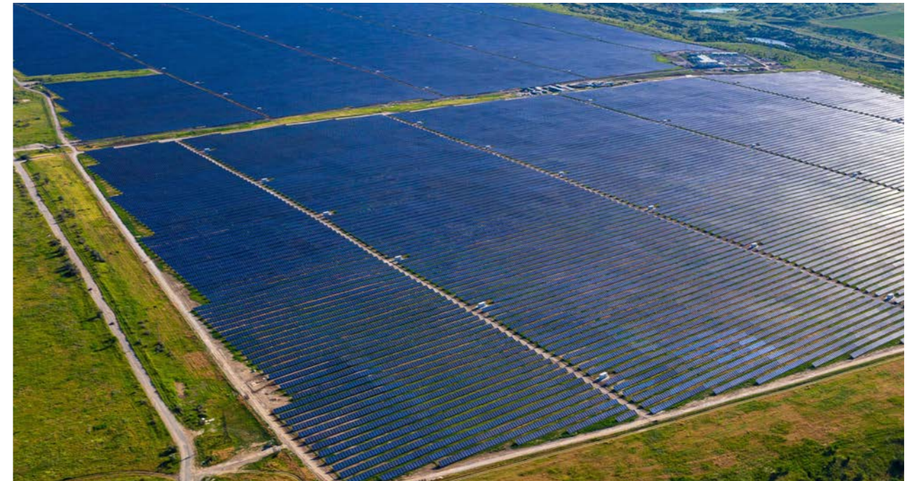
Зображення 9: Фото Нікопольської сонячної електростанції, неподалік від річки Дніпро (Дніпропетровська область) Автор/Джерело: ДТЕК
