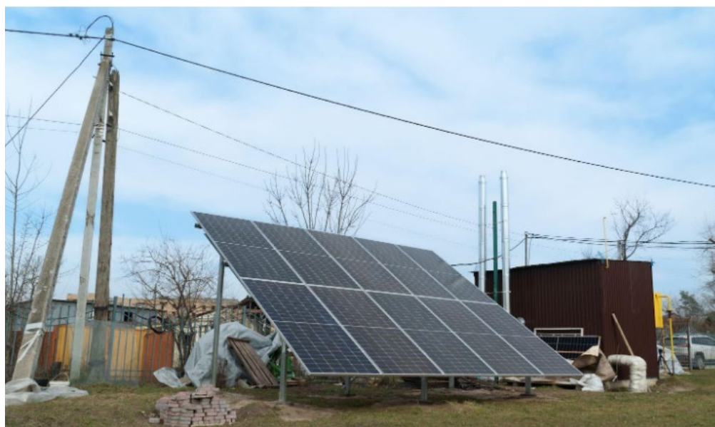
Фото 3. Гібридна сонячна електростанція у Мостищенській філії Ліцею № 1, м. Гостомель, Київська область
