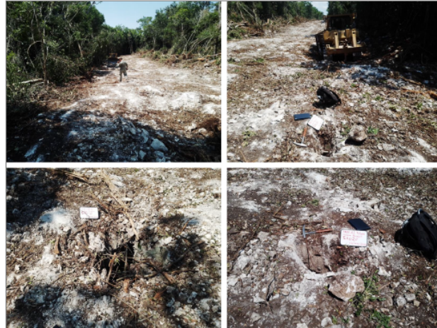
Figura IV.2.1.83. Oquedades halladas en el frente de avance del camino de acceso hacia el Aeropuerto Internacional de Tulum, en pleno proceso de despilme para iniciar su construcción.
