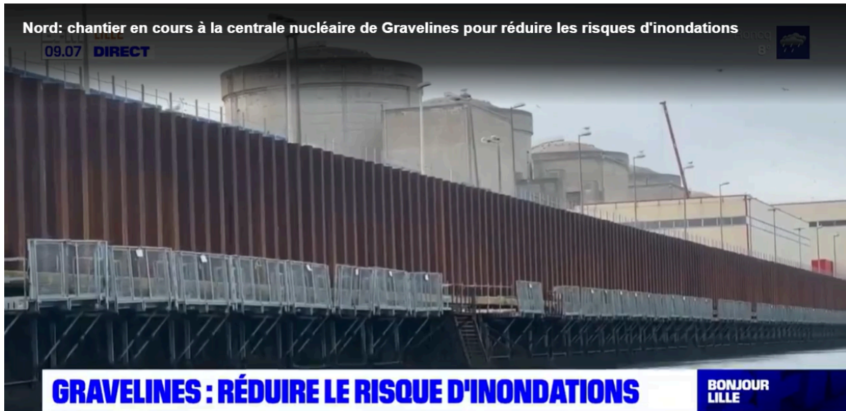
↑ Figure 6 : Bordure de palplanches d'une hauteur de 4 m d'après EDF 97 (Photo extraite d'un reportage BFM 98 )
