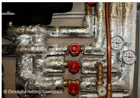
Parmi les mesures efficaces, isoler les conduits de chauffage et d'eau chaude.
