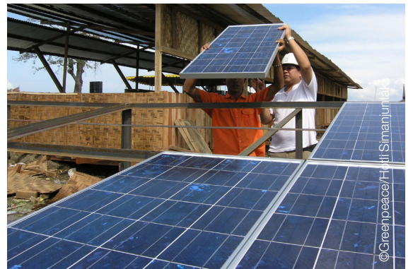
スマトラ島・アチェ州沿岸にある村に、太陽光発電システムを寄付するグリーンピース
