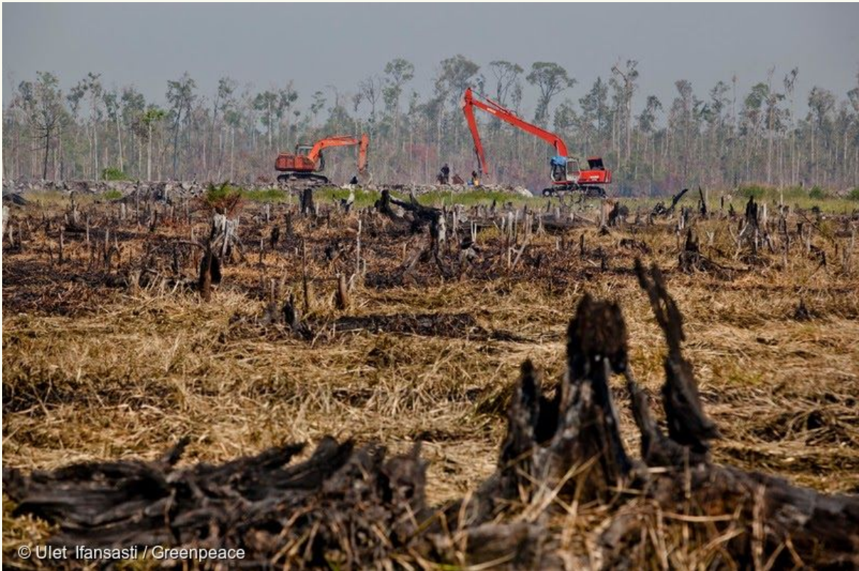
Ekskavator perusahaan menggali saluran drainase di perbatasan antara sisa hutan hujan dan tunggul yang hangus akibat kebakaran di lahan gambut yang baru saja dibuka di perkebunan kelapa sawit PT Rokan Adiraya Plantation dekat desa Sontang di Rokan Hulu, Riau, Sumatera. | 24 Jun, 2013
