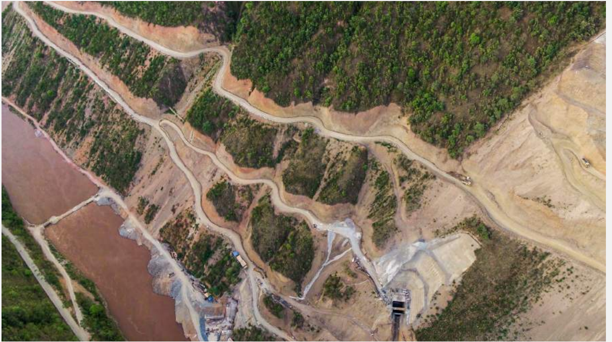
2017年6月18日，俯瞰云南省新平县戛洒江一级电站施工现场。电站修建对山体 and 河谷都造成了极大的破坏。 © 李玮 / 绿色和平
