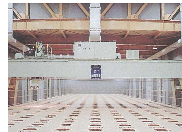
日本原子力研究開発機構 第三ウラン貯蔵庫 搬送設備 再処理工場で回収したウランを貯蔵する施設 写真提供:日本原子力研究開発機構
