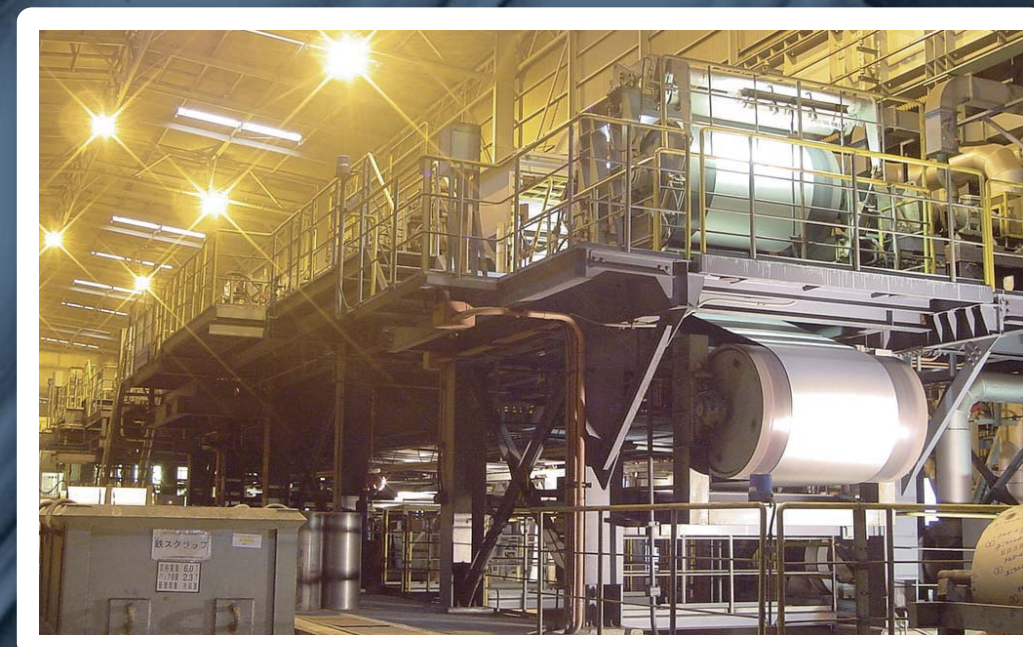
神戸製鋼所： 加古川製鉄所 チタン連続焼鈍酸洗ライン (APライン) 高品質チタン薄板の製造ライン
