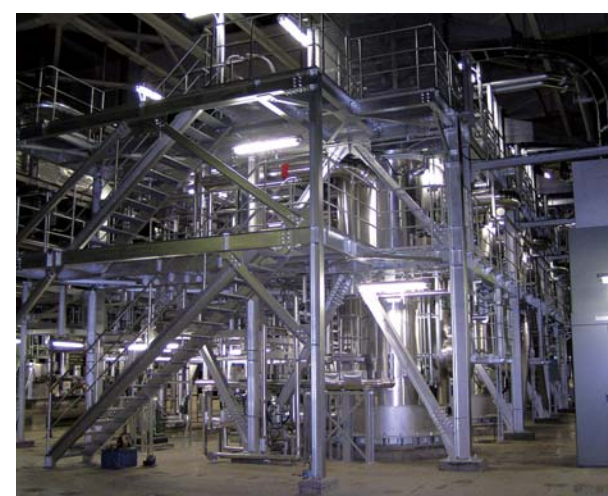
高電圧電極式ボイラー 発電タービン起動・停止時のシール蒸気や発電所建屋内の暖房等に使用する蒸気を供給するためのボイラー
